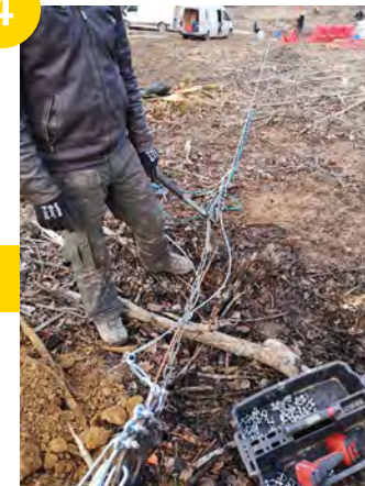
Tension des haubans
