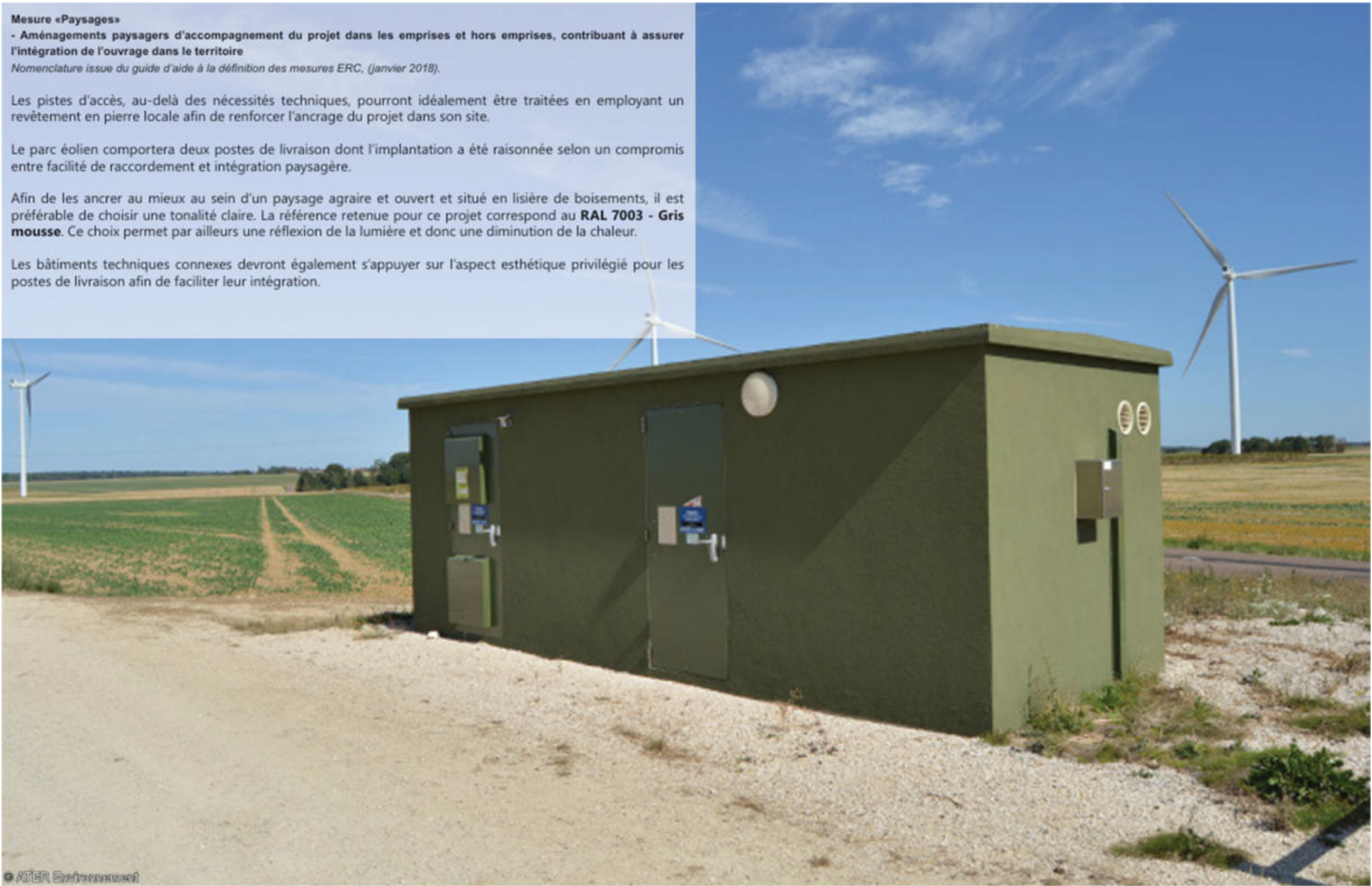
Figure 271 : Exemple de poste de livraison présentant la tonalité retenue (photo non contractuelle) (Source : étude paysagère, Mars 2025).
